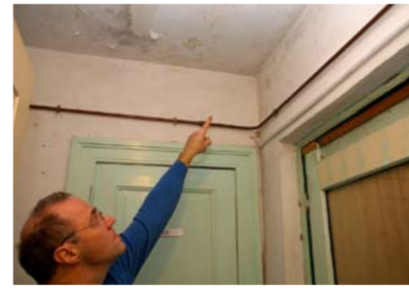
Un peu de ventilation aide l'humidité à s'évacuer.
